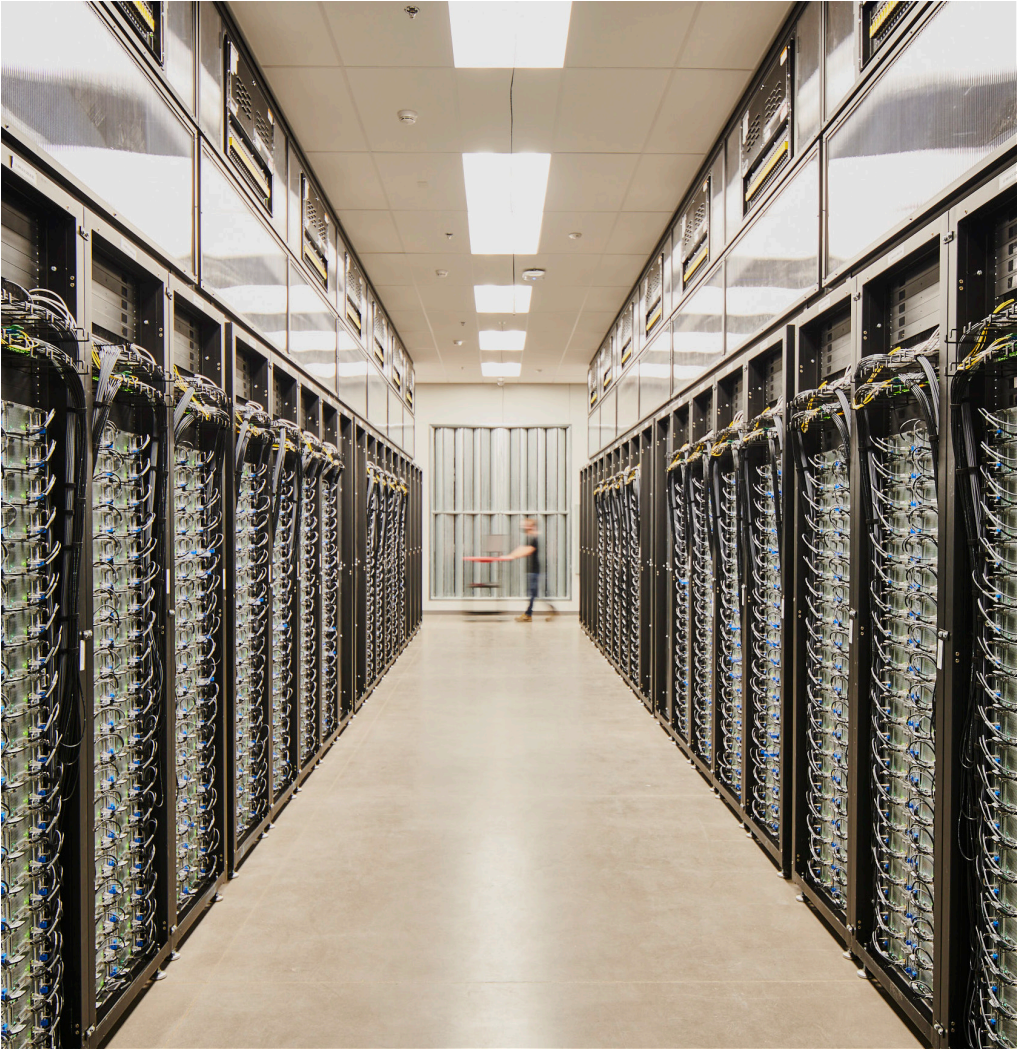
El centro de datos Reno de Apple, inaugurado en 2012, aprovecha el clima templado al enfriar sus servidores con aire exterior siempre que sea posible.
